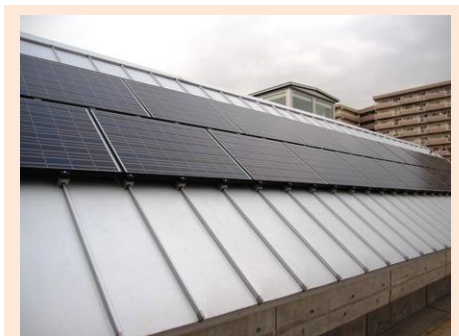
太陽光発電装置（立川市）
