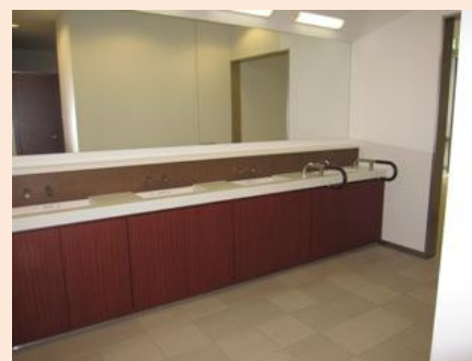
手すりのついた洗面所（青梅市）
